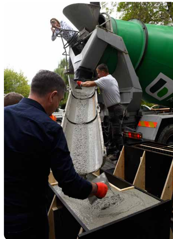
Zbyszka skierowany w stronę operatora – Wystarczy! Strumień zostaje przerwany. Teraz mieszanka musi dotrzeć do zakamarków deskowania. Na posterunku jest prof. Tomasz Kozłowski, który rozprawdza beton w formie. Ktoś pomaga zebrać resztę mieszanki do wiadra. Kacper Żak wibruje beton elektryczną bu-
